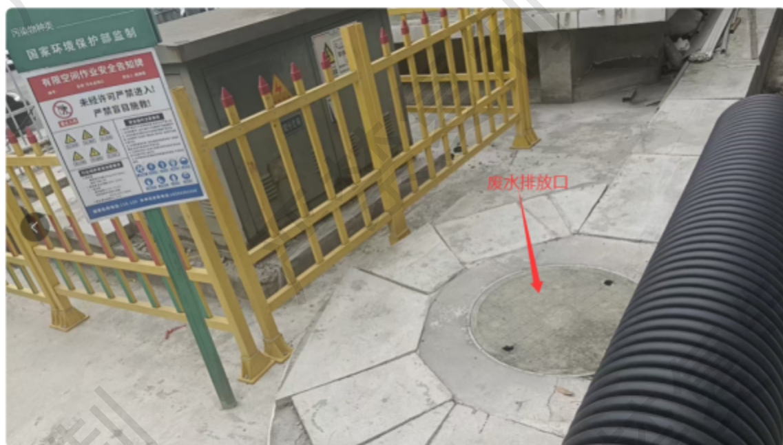
图 4.2-1 废水排放口现状图
