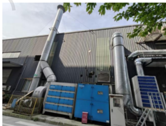
DA003（一段硫化排气筒）
