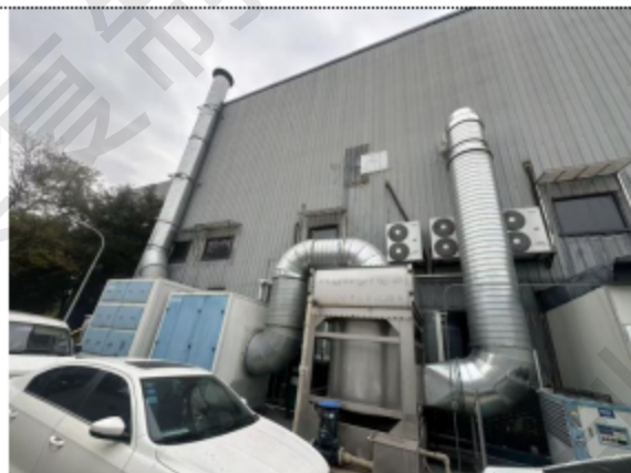
DA005（特殊装备排气筒）
