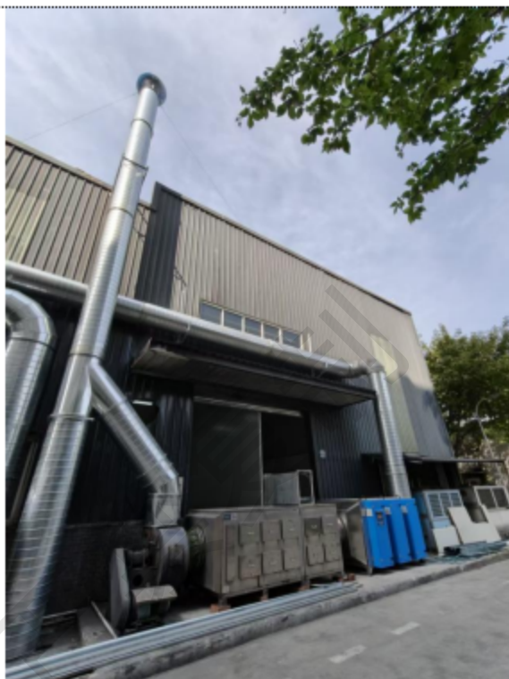
DA001（二段硫化排气筒）
